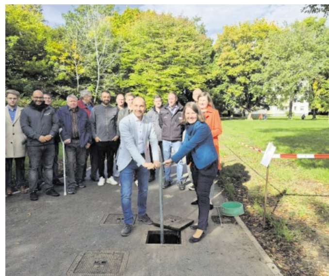
Dr. Stefan Belz und Sabine Kaebert nehmen den Fernwärmeanschluss offiziell in Betrieb.
